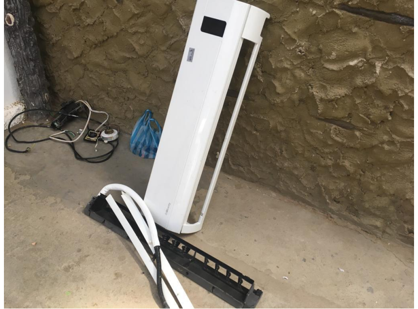
CARITA DE AIRE ACONDICIONADO PARA MANTENIMIENTO
